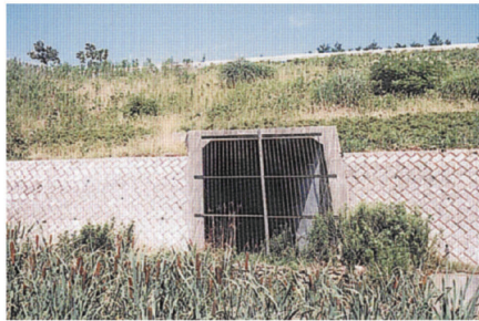
200年に一度の大雨に対応した導流水路と調整池
